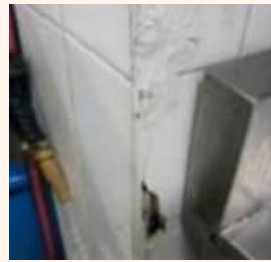
벽 파손 등 청결관리 미흡
