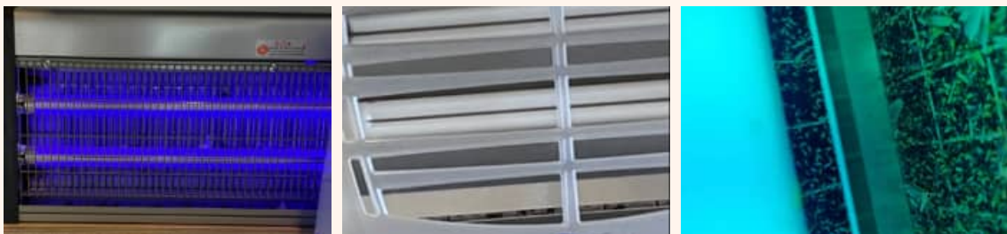
방충등 설치 미흡(충격식 포충등)
