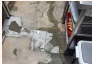
바닥 타일 균열 및 물고임
