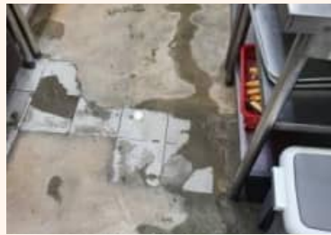
바닥 타일 균열 및 물고임
