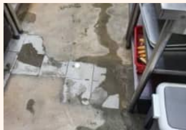
바닥 타일 균열 및 물고임
