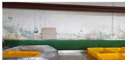
작업장 내 페인트 탈락
