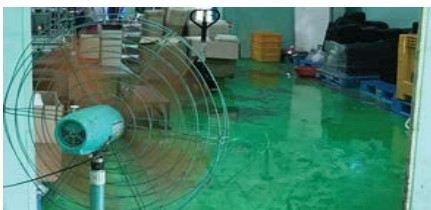
작업장 내 페인트 탈락 및 곰팡이 발생
