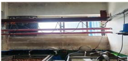
작업장 내 페인트 탈락 및 곰팡이 발생
